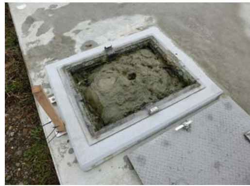
図-8 施設A調整槽内の発泡状況
