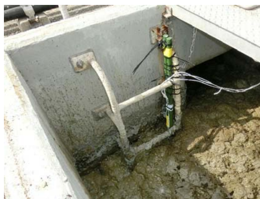
図-3 温度センサー設置状況
