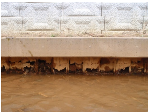
写真-2 腐食による欠損
