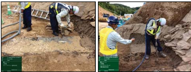
写真-4.2 クレイスラリーの塗布状況・コンタクトクレイエアタンパ締固め状況
