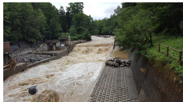
写真-3 しろがね頭首工の被災状況(8月23日撮影)
