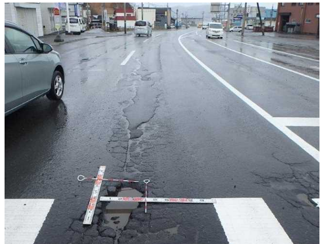
写真-1 ポットホールの発生状況
