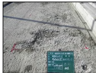
写真-9 橋面土砂化状況
