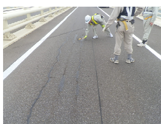
写真-3 並列状に発生したクラック
