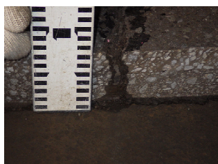
写真-4 グースアスファルトを貫通するクラック
