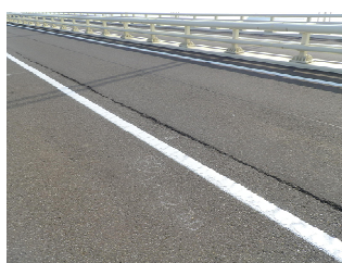
写真-2 直線状に発生したクラック
