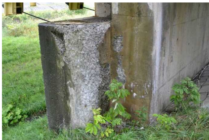
写真-1 凍害を受けたコンクリート構造物の一例
