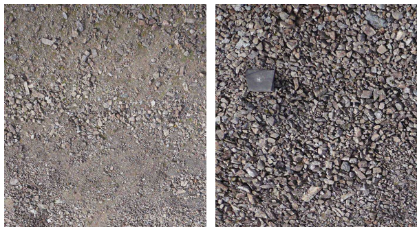
劣化部 健全部 写真-4 細粒化の例
