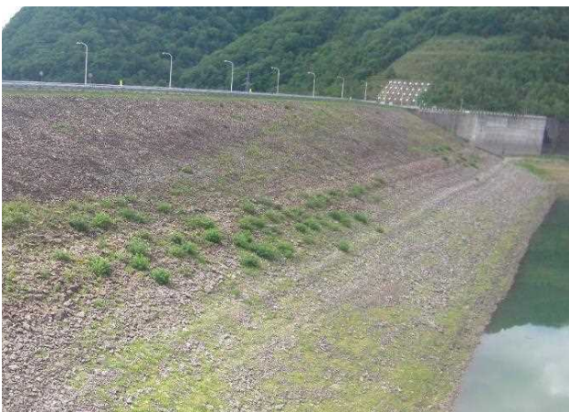
写真-1 植生繁茂状況
