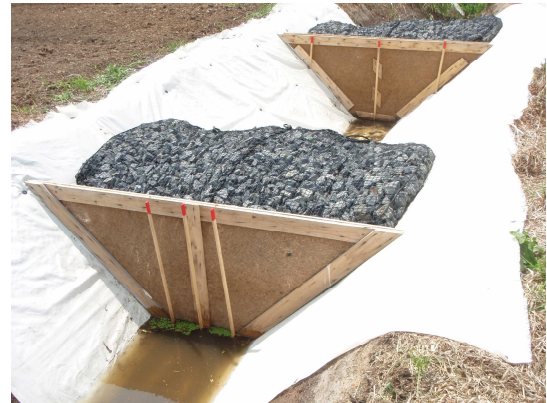
写真-6 濁水処理施設
