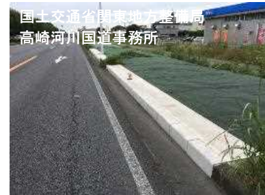
フィールド試験：平成28年05月～【検証中】 太田市東新町 国道50号線（東部工業団地交差点付近）
