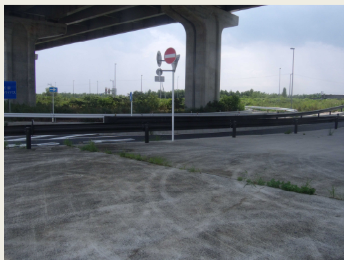
コンクリートシールを施工すれば防草効果高いが、継ぎ目からは雑草が繁茂する。
