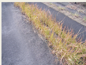
縁石目地から繁茂する雑草
