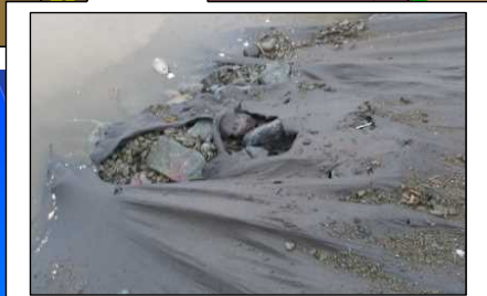
防砂シートの破損
