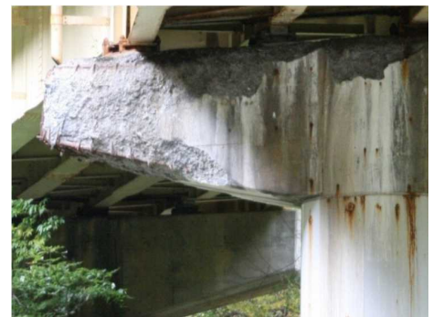
写真 凍害によるコンクリート構造物の劣化の一例
