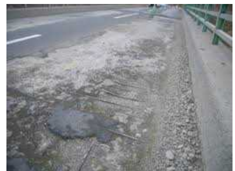
写真 床版の劣化の一例
