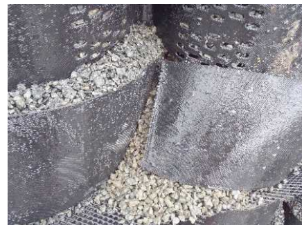
破損部の拡大
