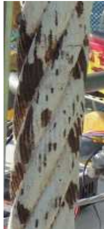
劣化塗膜が顕著
