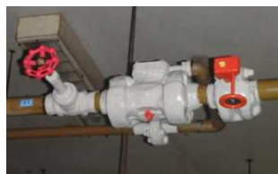
消火フランジ防錆 (緊急時簡単に解放出来る ことで採用)
