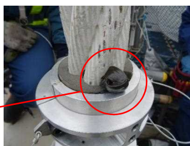
上部確認孔から 防錆剤漏出
