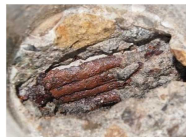
【PC鋼材の腐食】
