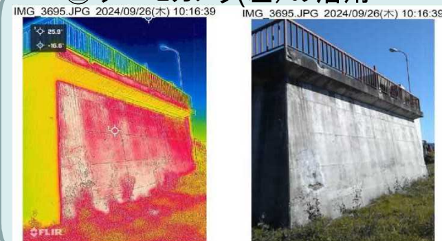
浮き・剥離は濃赤色
