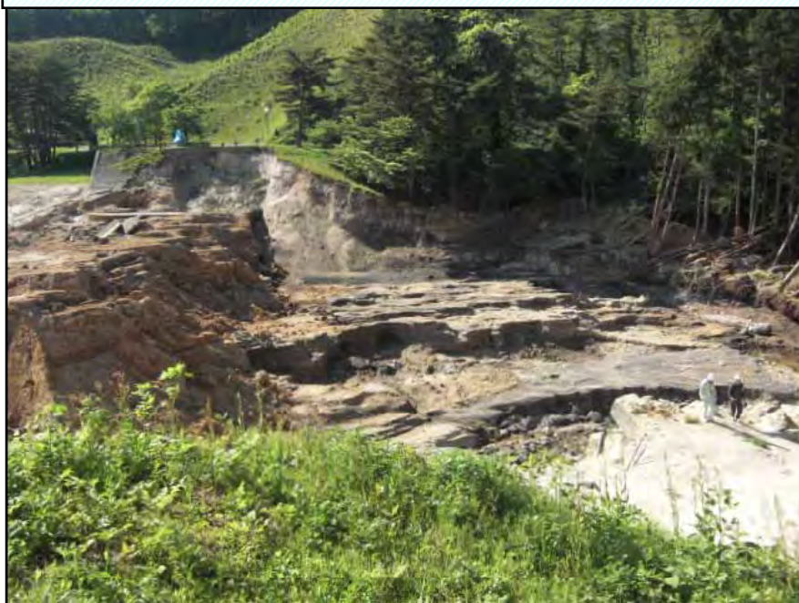
決壊した堤防(現地発生土にて築堤)
