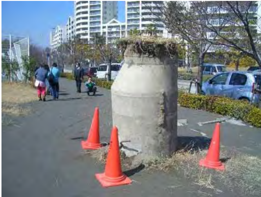
液状化より浮き上がったマンホール
