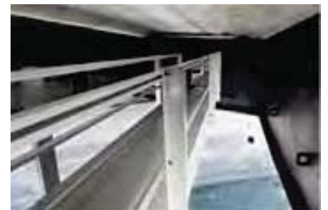
■KERO 設置状況
