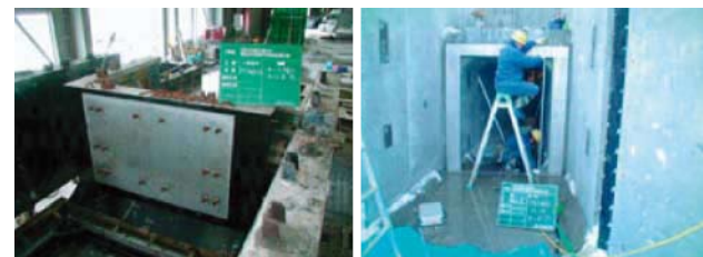
■油圧開閉機架台金物
