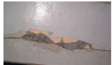
■第2床丹橋の桁下損傷状況 (塩害による補修材の再劣化)
