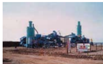
■ザンドックス工法プラント
