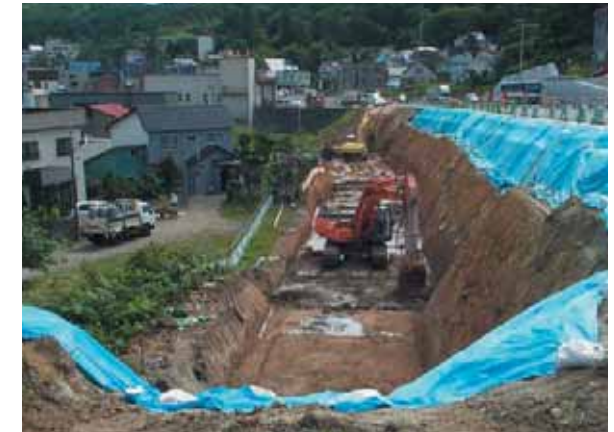
■住宅地に近く狭小な施工現場での施工状況 狭小な施工現場で機能性を確保します。また、低騒音、低振動のため、周辺環境への影響を最小限にできます。
