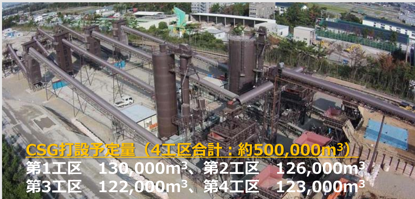
連続式CSG混合設備外観
