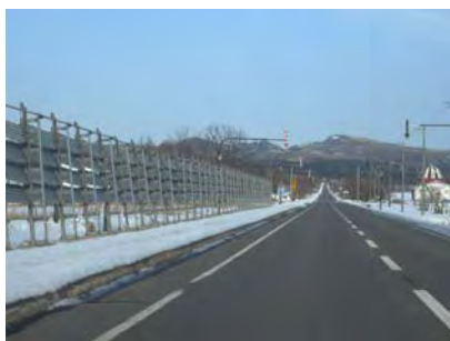
防雪柵と固定式視線誘導柱が重複設置されている事例。(道道52号・弟子屈町)
