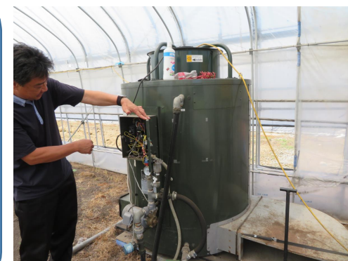
ハウス内のバイオガスプラントの暖房機器
