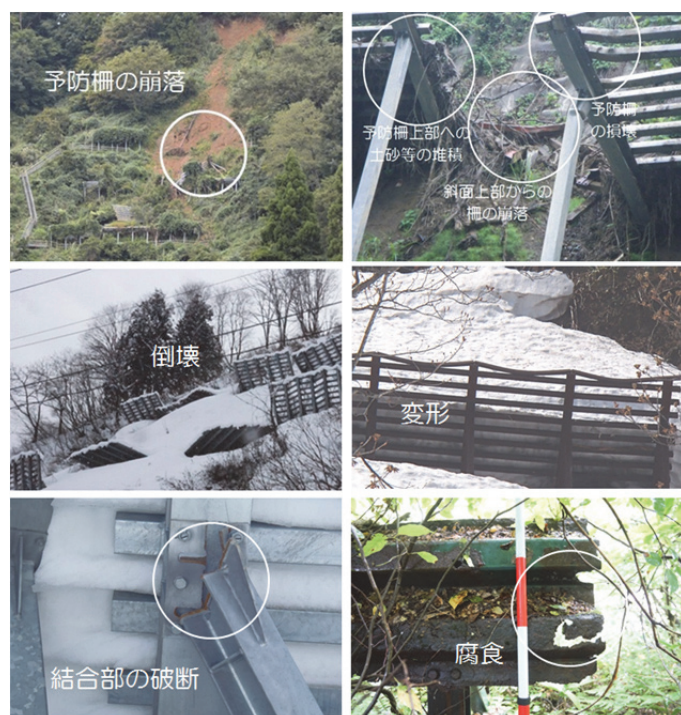
図1 雪崩対策施設の損傷例
