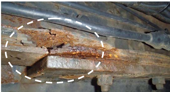
写真-2 フレームの腐食・亀裂状況
