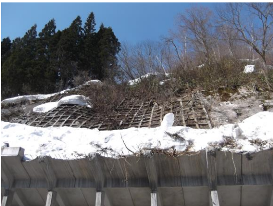
写真-4 雪崩が発生した斜面の状況
