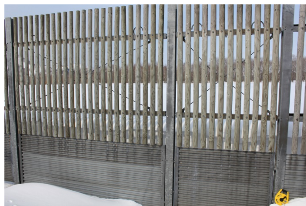
写真1 防雪林風上側の吹きだめ柵
