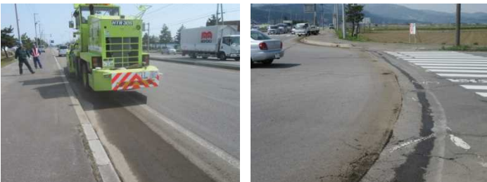
写真-10 塵埃取り残し状況
