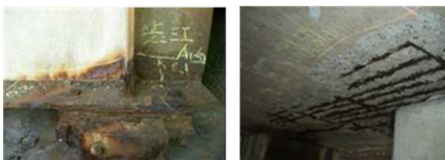
写真1 塩散布による構造物の塩害
