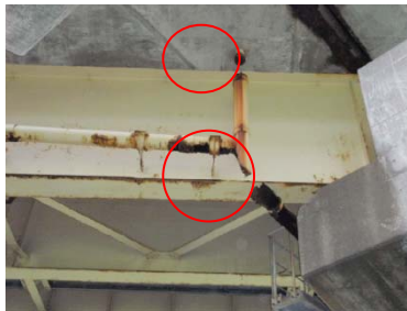
写真-1 排水管の劣化状況
