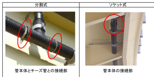
写真-3 漏水の発生箇所
