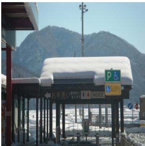
写真14 ヒーター有り 北陸自動車道 南条SA駐車场上屋
