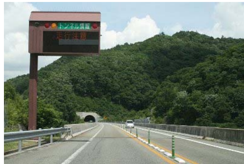
写真3 ヒーター設置前道路情報板 (ヒーター設置前) 東海北陸自動車道 上小鳥TN情報板 (岐阜県高山市)
