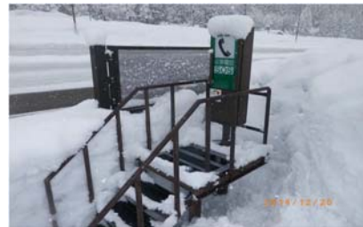
写真16 東海北陸道 非常電話設置状況（富山市） 降雪時
