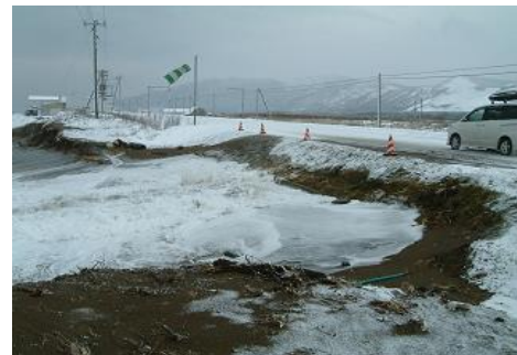
写真-2 波浪による盛土の被災状況
