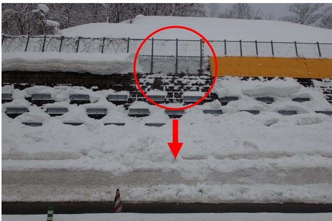
写真-11 落雪状況写真【案①】
