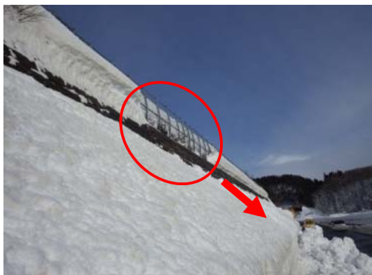
写真-1 落雪状況写真(立入防止柵)
