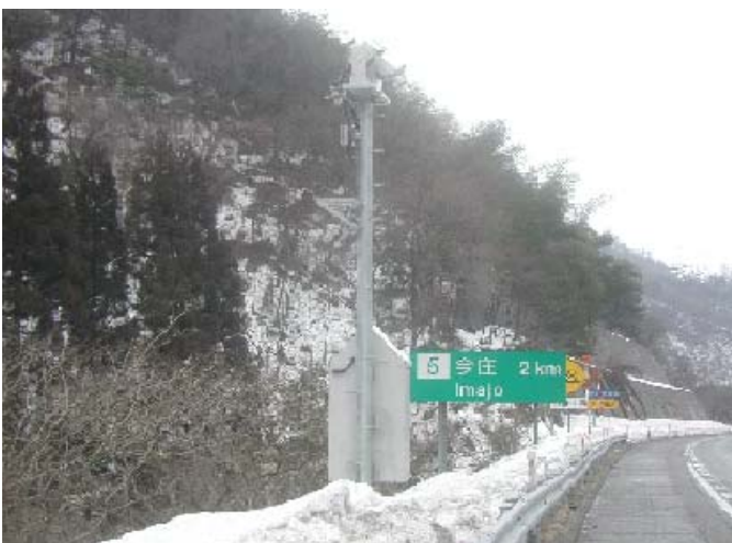
図 1 路面降雪監視システム
