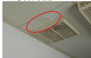
漏水天井材の損傷
