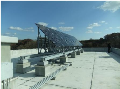
太陽光発電設備
