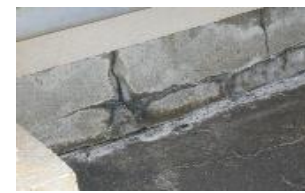
屋上躯体ひび割れ
