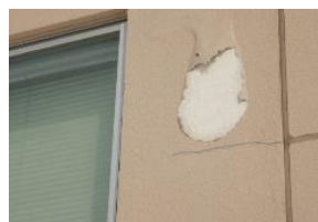
外壁のひび割れ 外装材剥離
