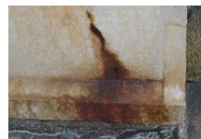
外壁ひび割れ鉄筋の錆汁
