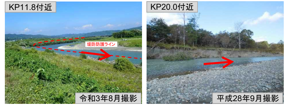
写真5-1 河岸侵食箇所の状況
