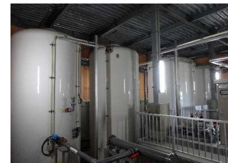
清浄海水導入施設(貯水槽)
