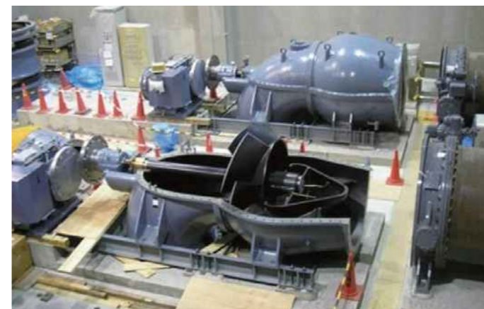
機械設備の更新・維持管理 (排水機場)
