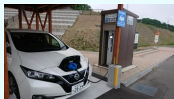
道の駅「石狩あいろーど厚田」での充電状況
