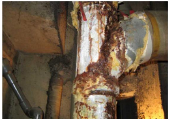
排水管の腐食により漏水が発生し配管改修が必要（整備前の状況）
