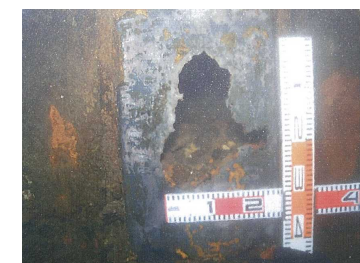
岸壁の老朽化状況(本体の腐食)
