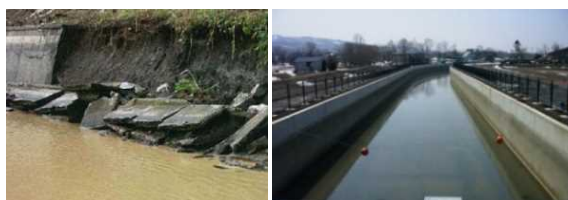
倒壊した用水路
