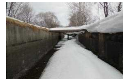
雪庇の影響を受ける用水路
