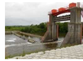
転倒のおそれ がある頭首工
