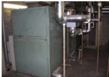
空気調和機劣化状況 (整備前の状況)
