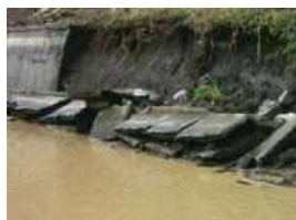
倒壊した用水路
