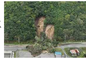
令和5年10月 大雨による土砂崩れ状況 (国道336号 様似町)
