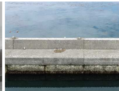
漁港施設 (本土工) の老朽化 (歯舞漁港)
