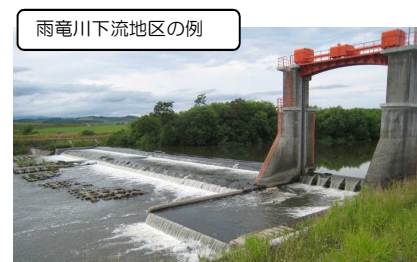
防災対策が必要な頭首工
