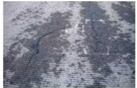
誘導路舗装の劣化状況
