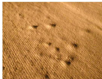
舗装の損傷（舗装の浮き上がり） ※写真は光源位置の工夫により見えやすくしたもので、凸部が損傷箇所
