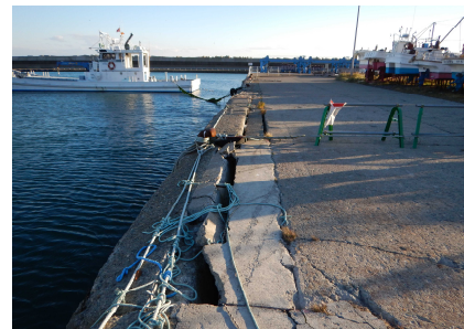
老朽化が著しい岸壁 (庶野漁港)
