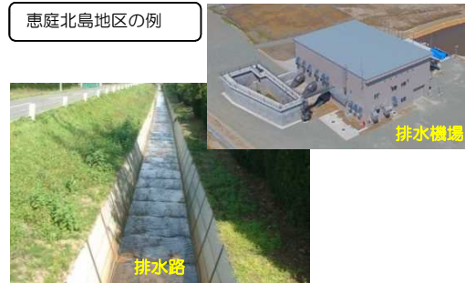
更新整備した排水施設
