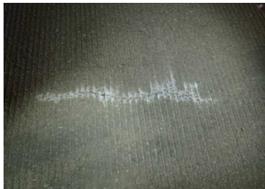
舗装の損傷（クラック）
