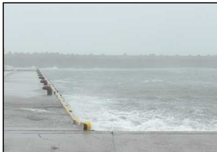
防波堤越流により岸壁へ波が遡上した例
