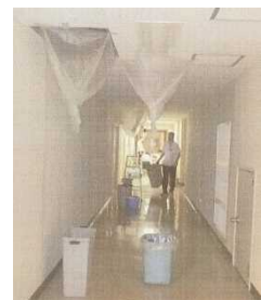
天井からの漏水
