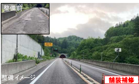
〈道路インフラの老朽化対策〉
