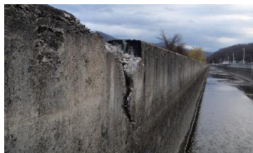
凍害による用水路側壁の亀裂
