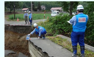
豪雨での被災状況調査を行うTEC-FORCE(名寄市)
