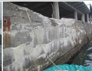
漁港施設の老朽化状況 (古平漁港)
