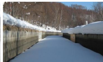
雪庇の影響を受ける用水路
