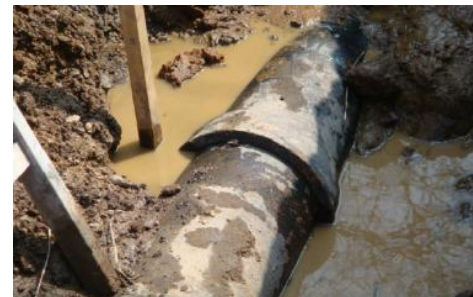
管水路からの漏水
