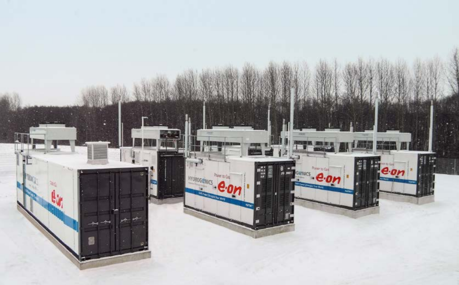
2012 年 12 月に納品された 2 MW プラント
